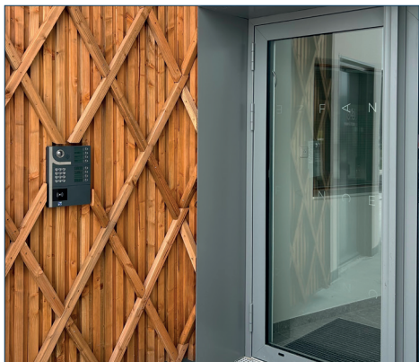
Interphone 8 boutons à l'entrée du nouveau pôle enfance de la ville de Montbert (44)
